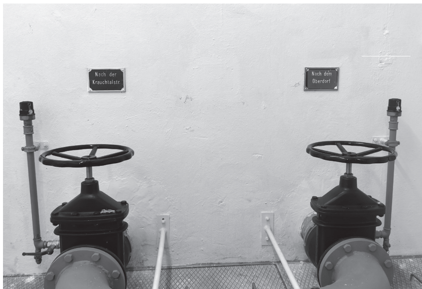
Foto: Energie- und Wasserversorgung Oberburg
