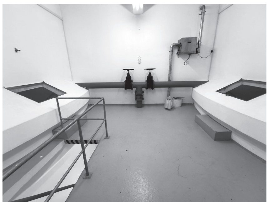
Foto: Energie- und Wasserversorgung Oberburg
