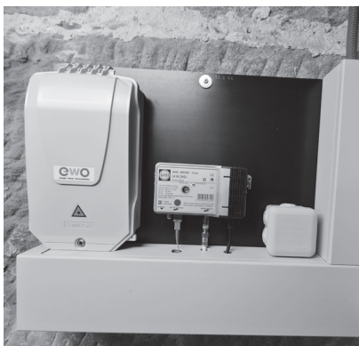
Glasfaser-Gebäudeanschlusskasten (Building Entry Point, BEP)
