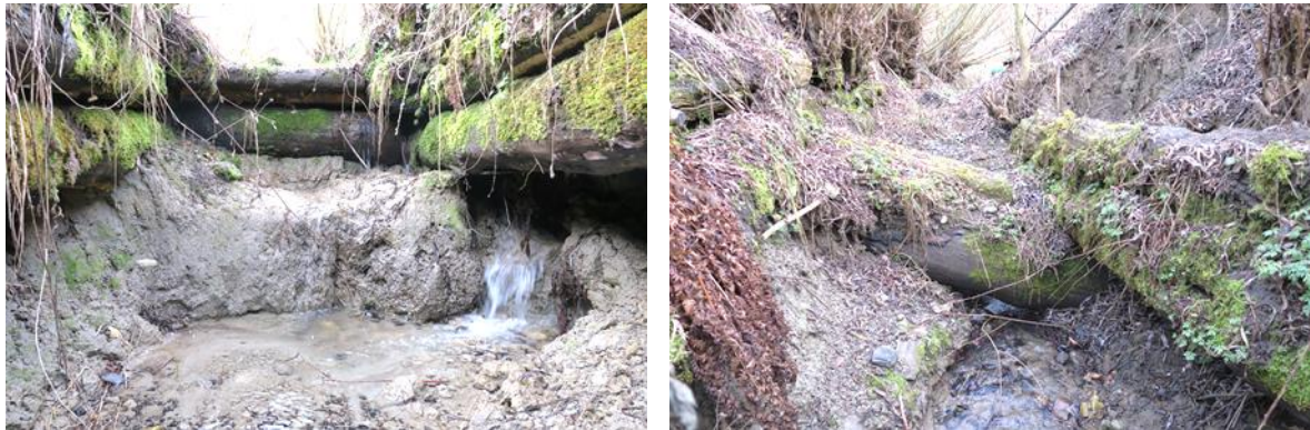
Abbildung 5: Schadstellen an der Gewässersohle und den bestehenden Längs- und Querverbauungen des Fondsbachs
