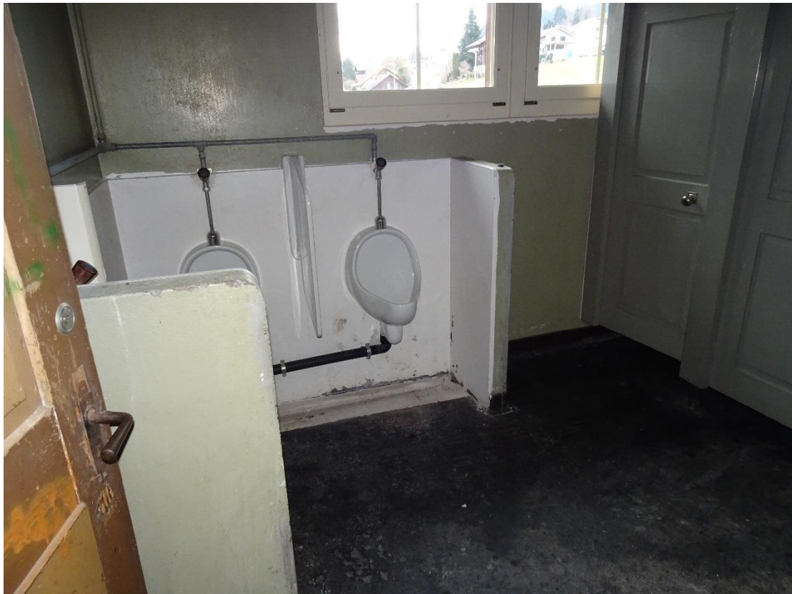
Alte WC Anlagen 1. und 2 OG.
