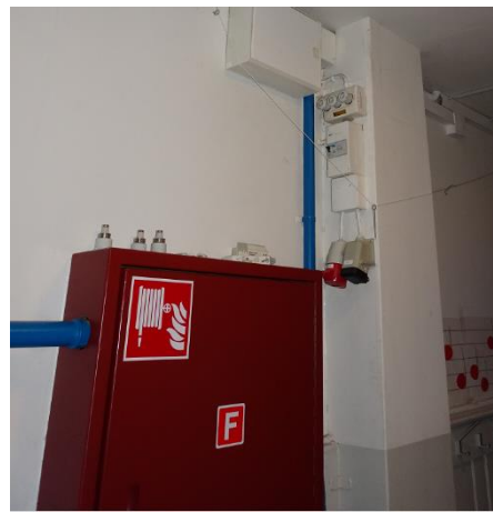
Alte Elektroverteilung Flur 1. OG
